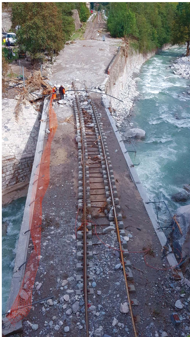
Figure 1 – Tempête Alex – 30/09/20 au 03/10/20 – vallée de la Vésubie. Dégâts sur les ouvrages et la voie.
