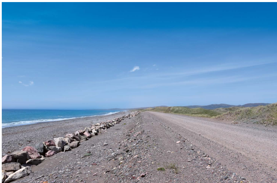
Figure 2 – La route de l'isthme de Miquelon-Langlade, fine bande de terre menacée par l'érosion, la submersion et l'élévation du niveau de la mer.
