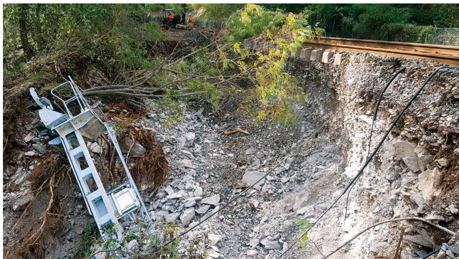
Figure 2 – Tempête Alex – 30 septembre au 3 octobre 2020 – vallée de la Vésubie. Empolement du remblai et arrachement des équipements ferroviaires.
