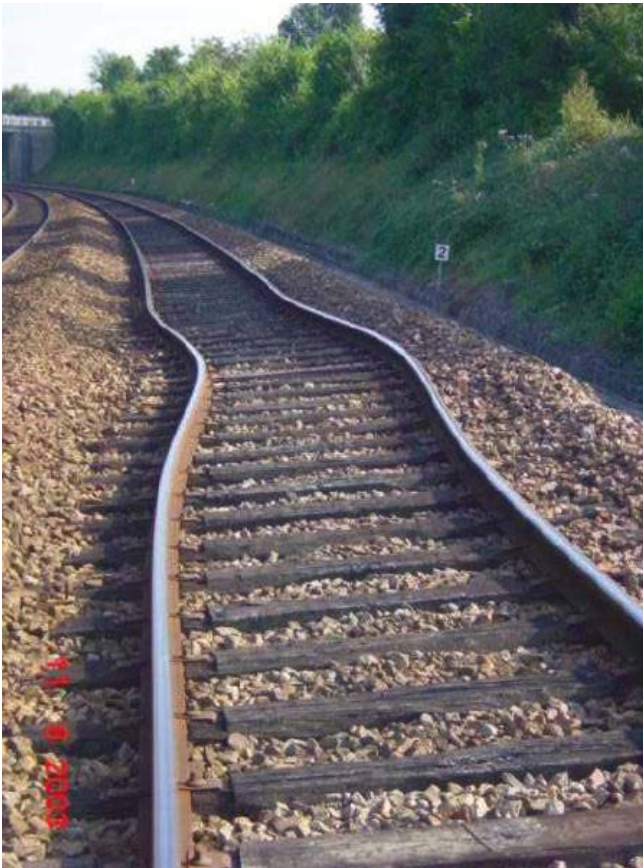
Figure 4 – Déformation de la voie sous l'effet de fortes chaleurs.
